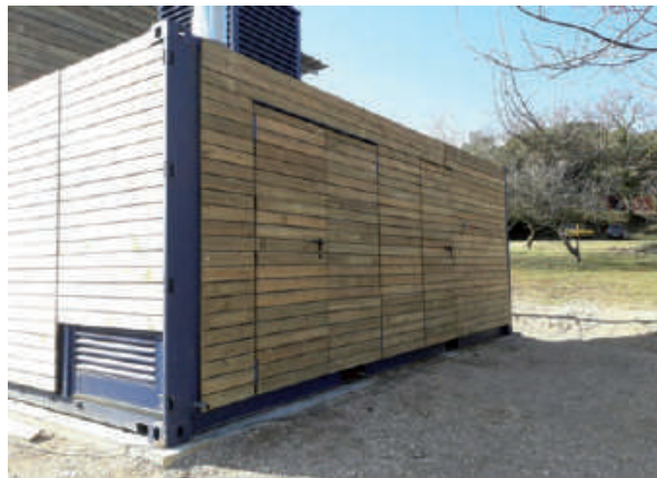
La instal·lació de la caldera de biomassa ha estat possible gràcies a una subvenció
